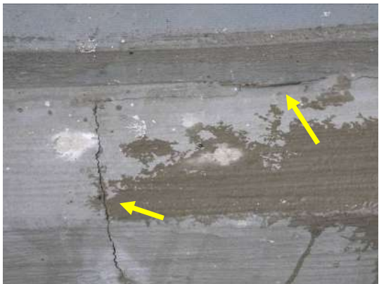
Viele Fundamentrisse nach einem Betriebsjahr
