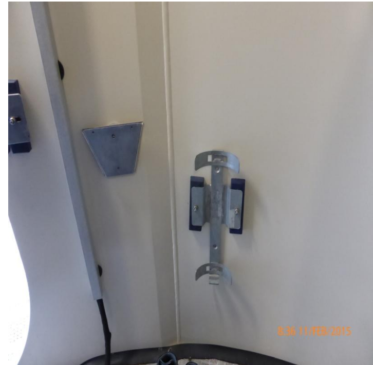
Turmsystem UMD 10 -fehlende Sicherheitseinrichtung-
