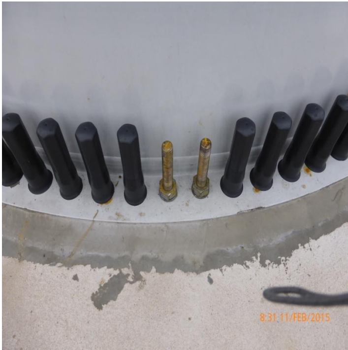
Turmfuß UMD 29 -fehlende Abdeckung-
